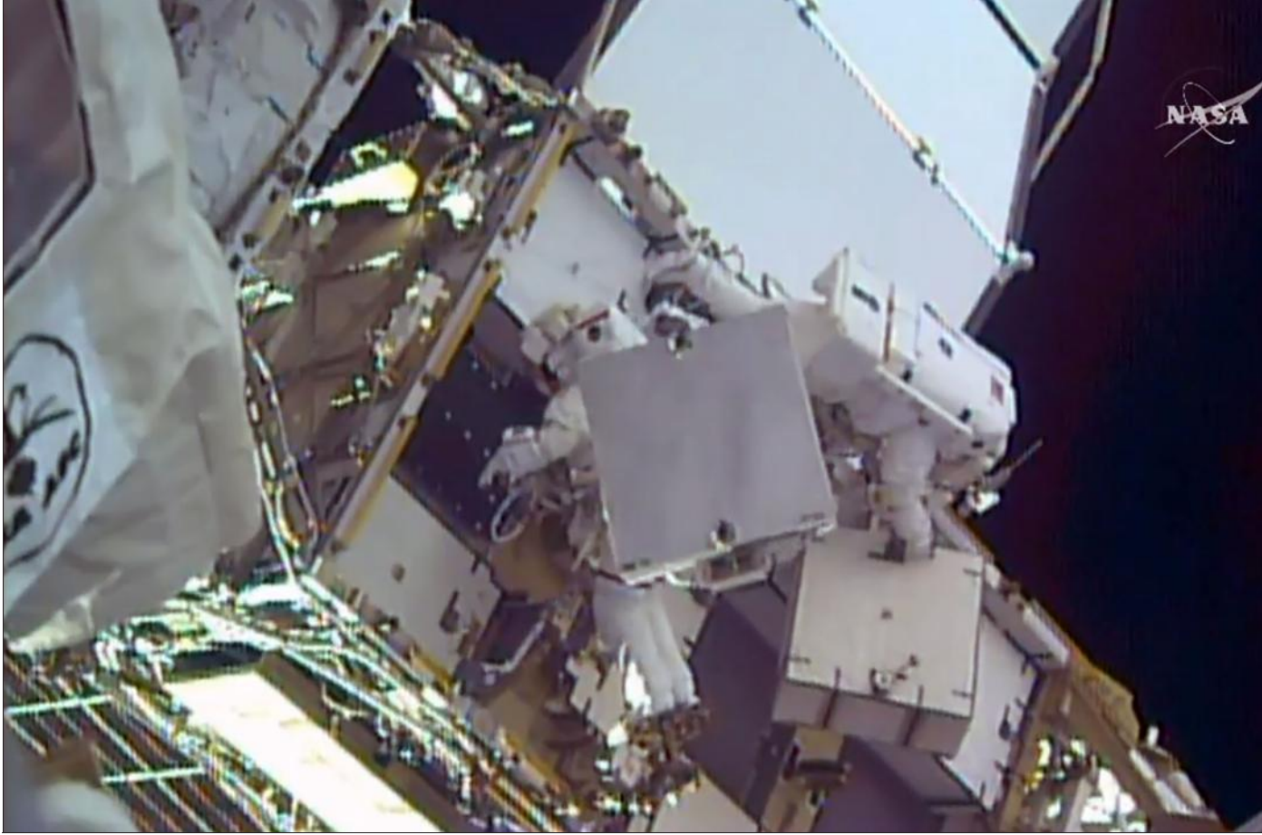
Les trois batteries lithium-ion branchées par les deux hommes pesaient 200 kilos chacune. Il y a 24 batteries de ce type sur l'ISS. Photo AFP
