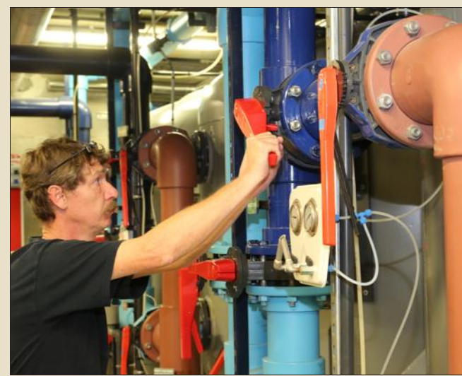
Deux techniciens doivent veiller au bon fonctionnement des machines de la piscine de Sarrebourg. Photo Laurent MAMM
