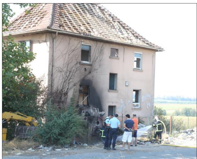
Le feu a pris le long de la façade arrière, alors que le bâtiment est en travaux. Photo Laurent MAMI
